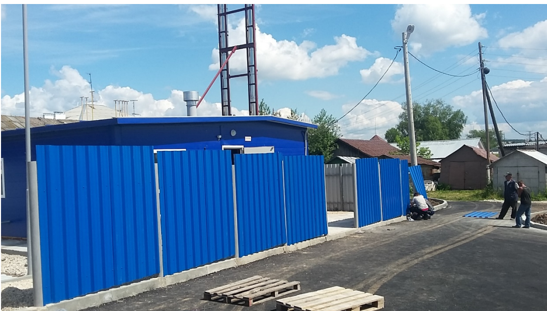
БМК 3МВ г. Атиг
